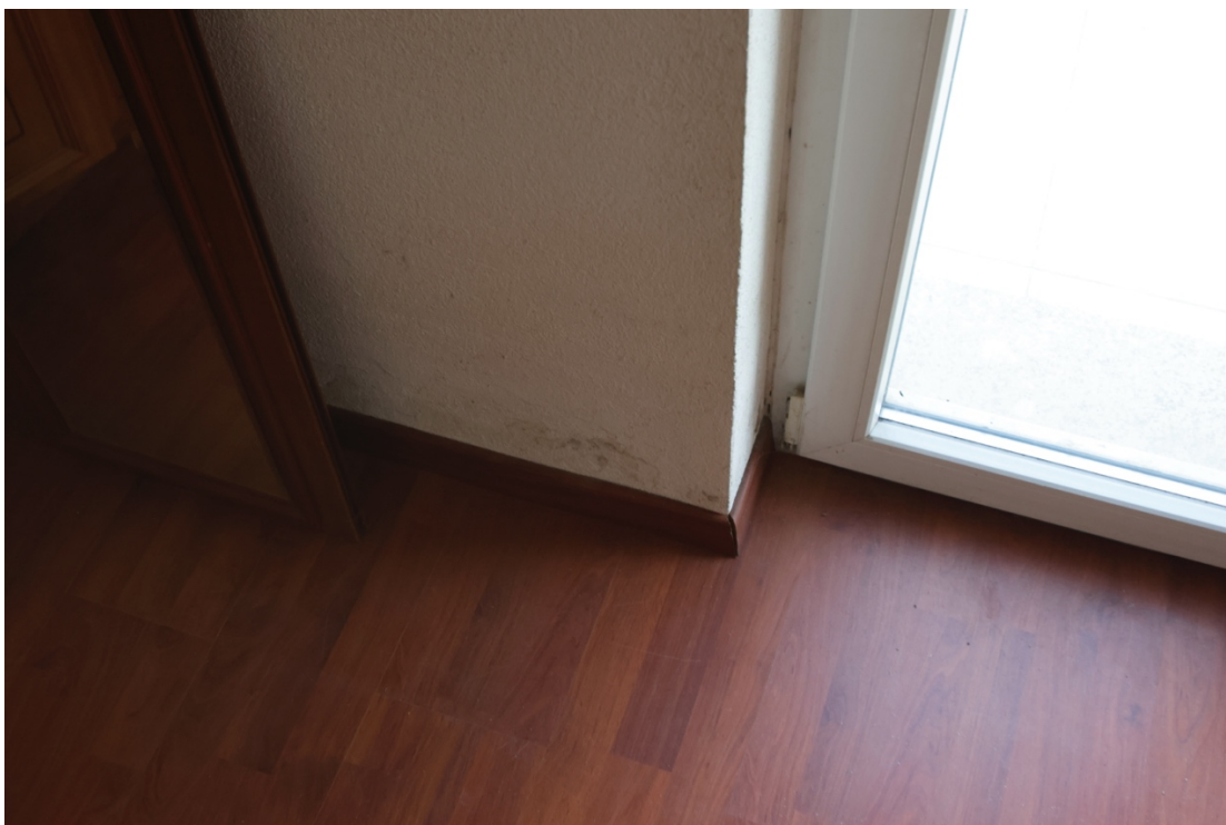
1P – Camera matrimoniale, dettaglio danno umidità
