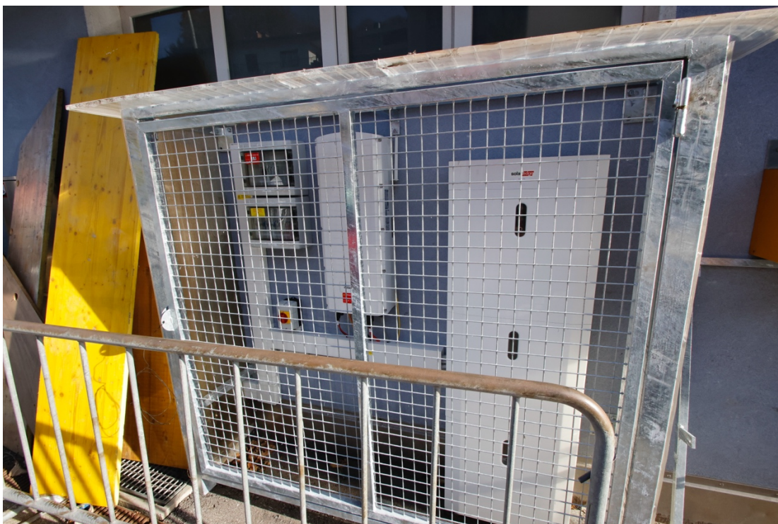
PT – Inverter impianto FV e batteria ad accumulo
