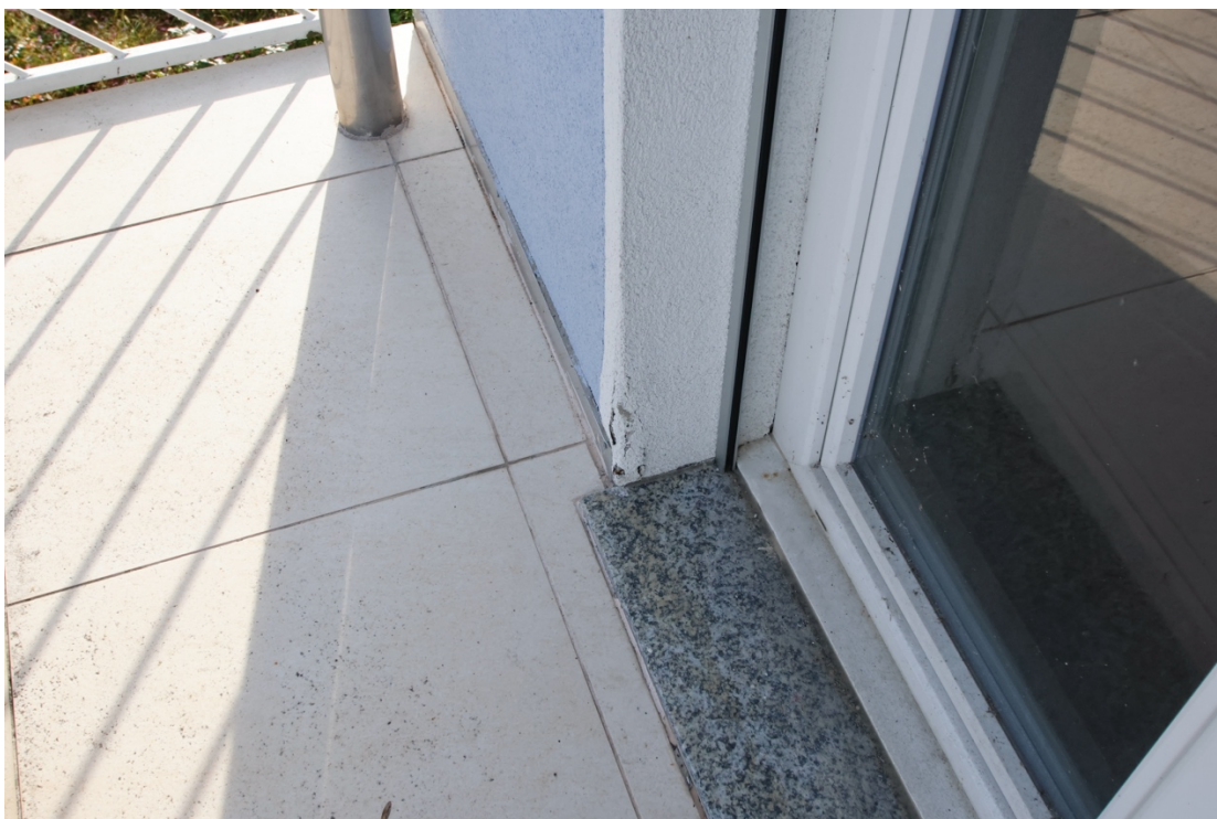
1P – Balcone, dettaglio danno umidità
