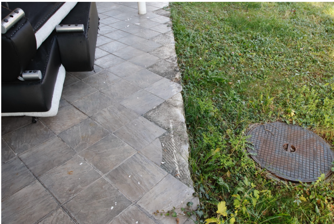
PT – Terrazza, dettaglio danni alla superficie
