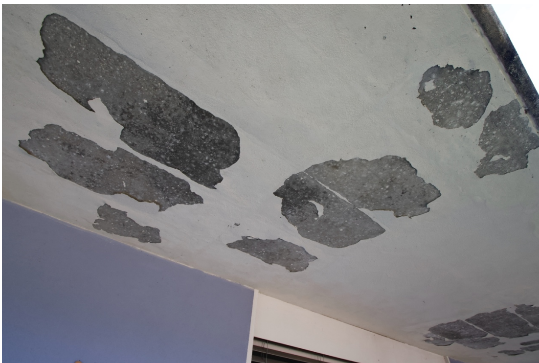
PT – Terrazza, dettaglio danno umidità
