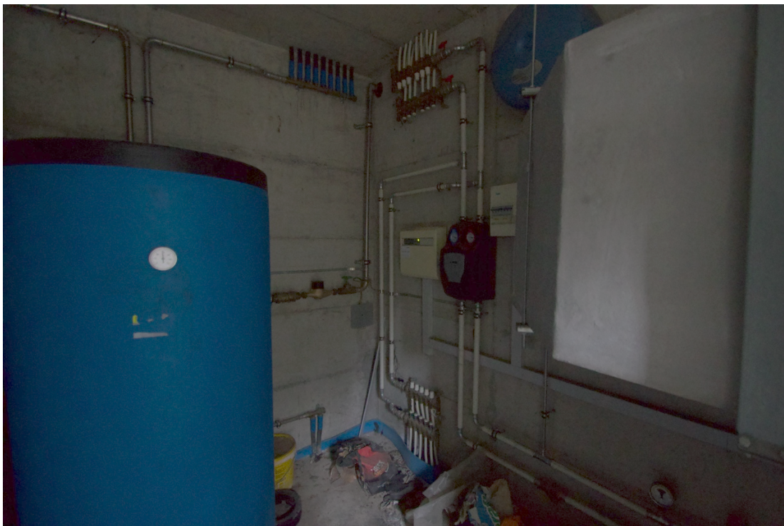
PT – Locale tecnico
