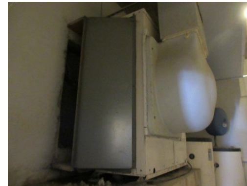
Pompe à chaleur
