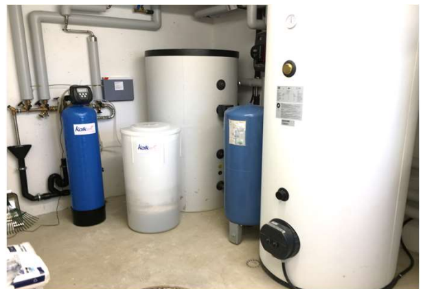
Boiler / Speicher / Entkalkung
