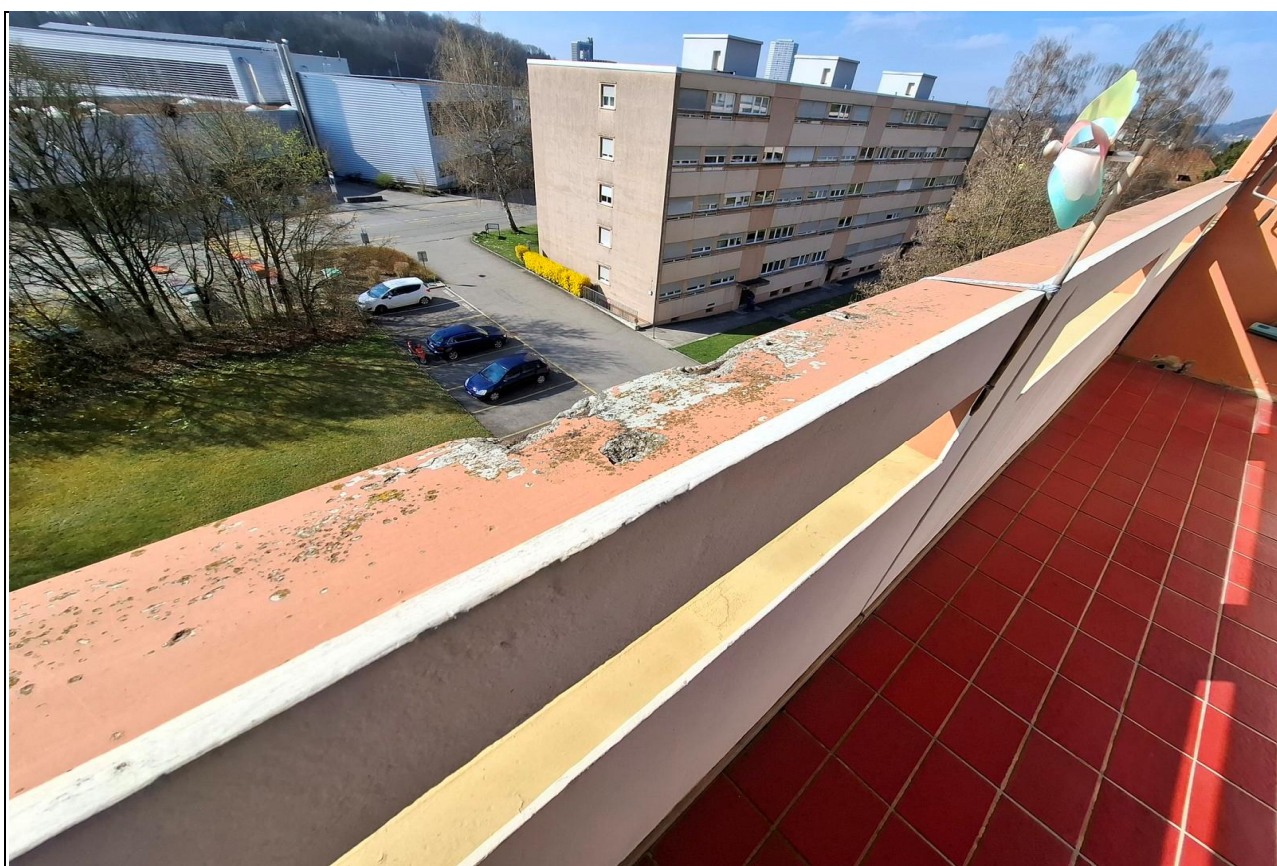
Balkon (Brüstung nicht gesetzeskonform)
