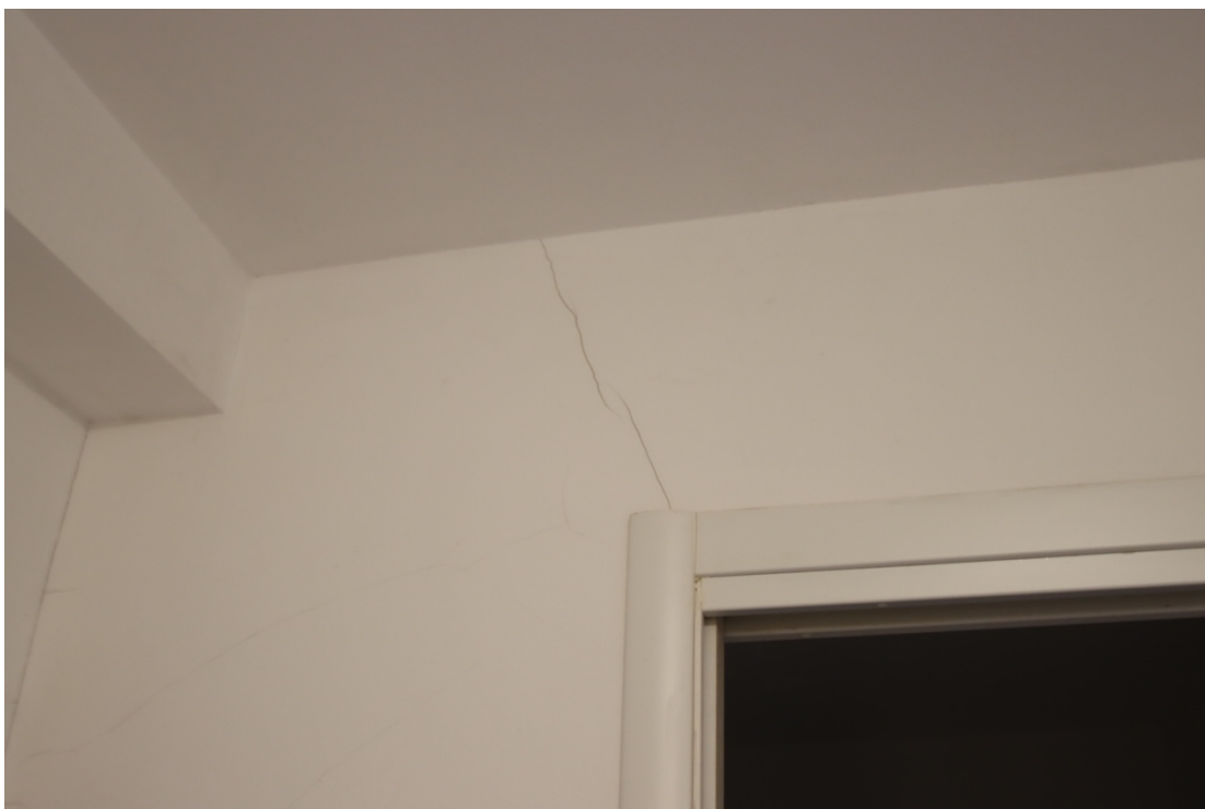
Dettaglio crepa sopra porta della doccia
