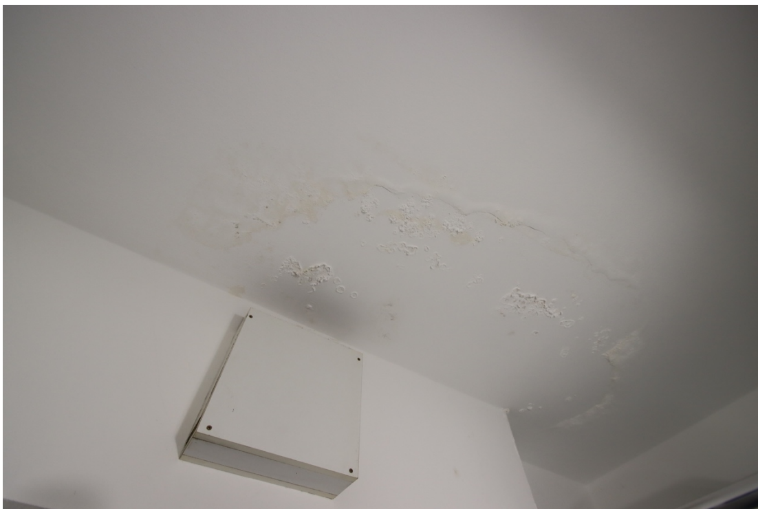
Dettaglio danno infiltrazione
